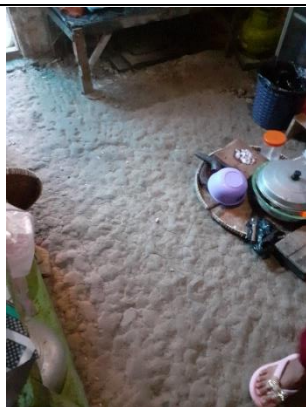
Jenis Lantai Tidak Kedap Air
