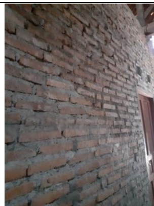
Jenis Dinding Tidak Kedap Air
